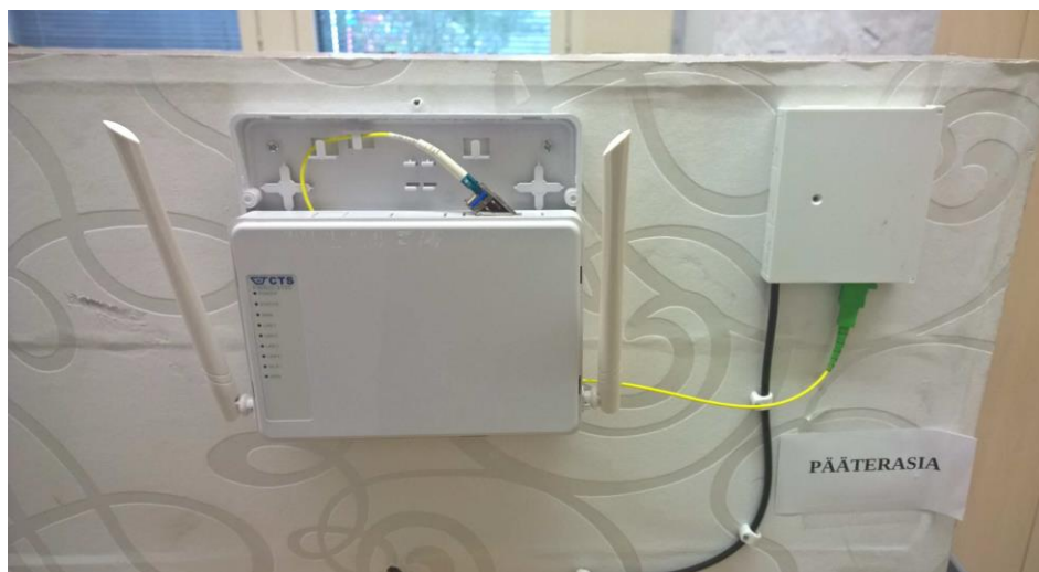
Kuva 4: SFP ja kuitu kytkettynä päätelaitteeseen.
