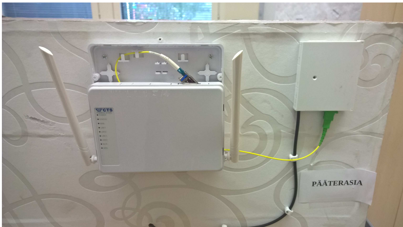
(Kuva 6. SFP ja kuitu kytkettynä päätelaitteeseen.)
